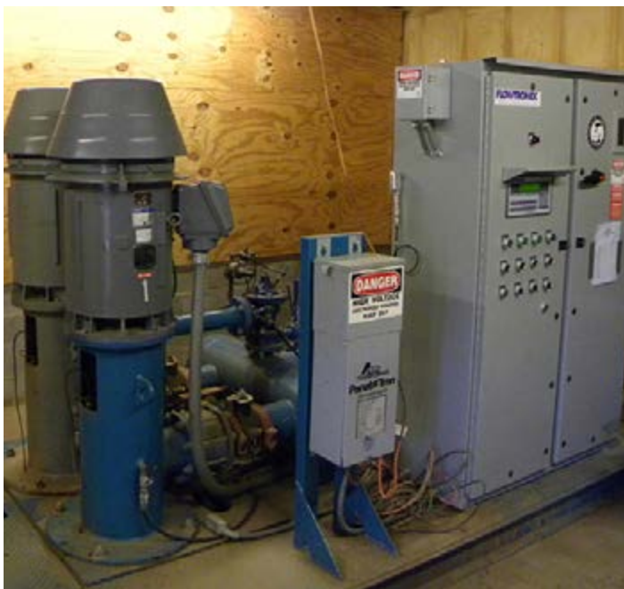
Estaciones de bombeo de gran alcance se mantienen detrás de escena, pero juegan un papel vital en el suministro de agua al césped del campo de golf.
