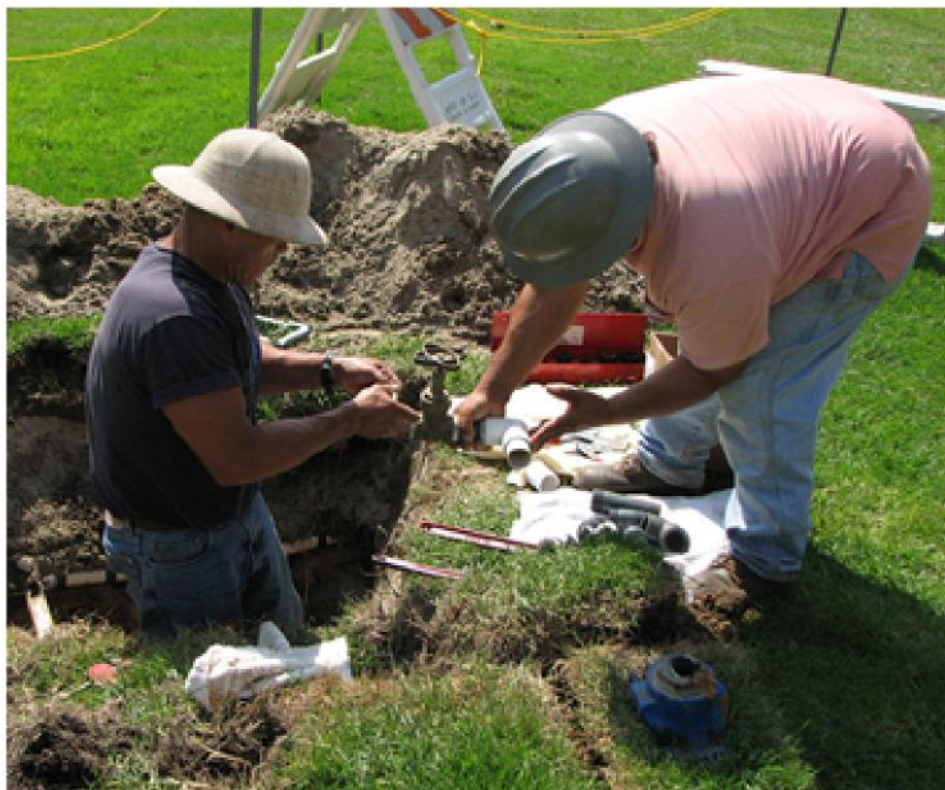
阀门出现故障，管道频繁地破裂，这就表示灌溉系统磨损严重，需要更换了。
