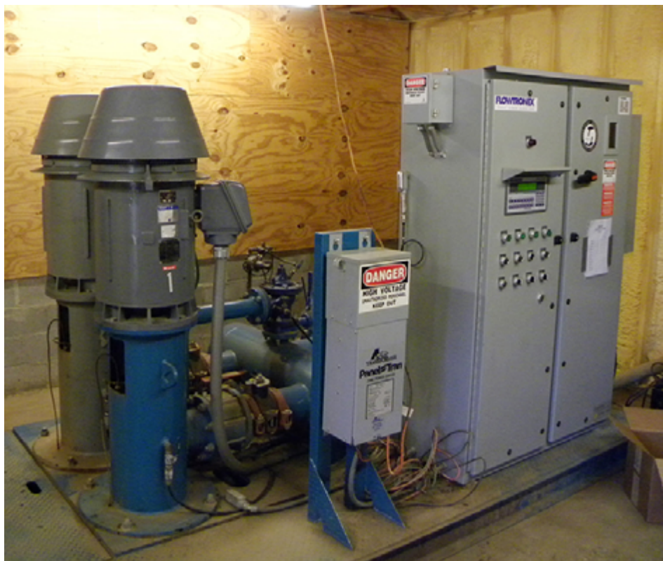
泵站提供动力将水推入灌溉管道，最终通过在高尔夫球场各个区域的灌溉喷头。
